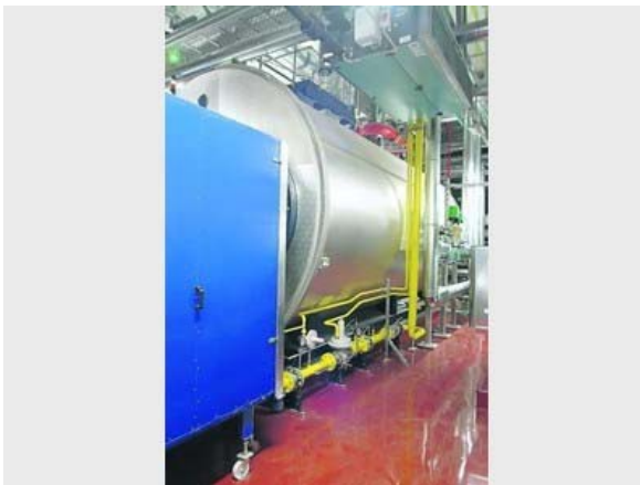
Eine Heißwasserkesselanlage plant und baut die Kulmbacher Firma AGO für die Brauerei Heineken South Africa. Foto: pr
