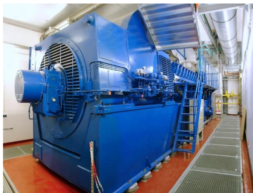
Gasmotor mit Generator (Blockheizkraftwerk)
