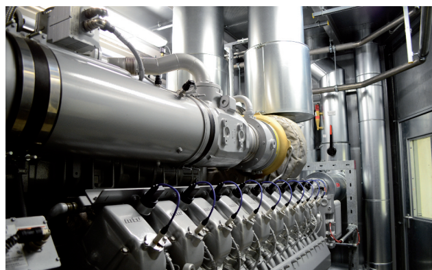
MTU BHKW mit 2 MW elektrisch bei der Molkerei Gropper.
