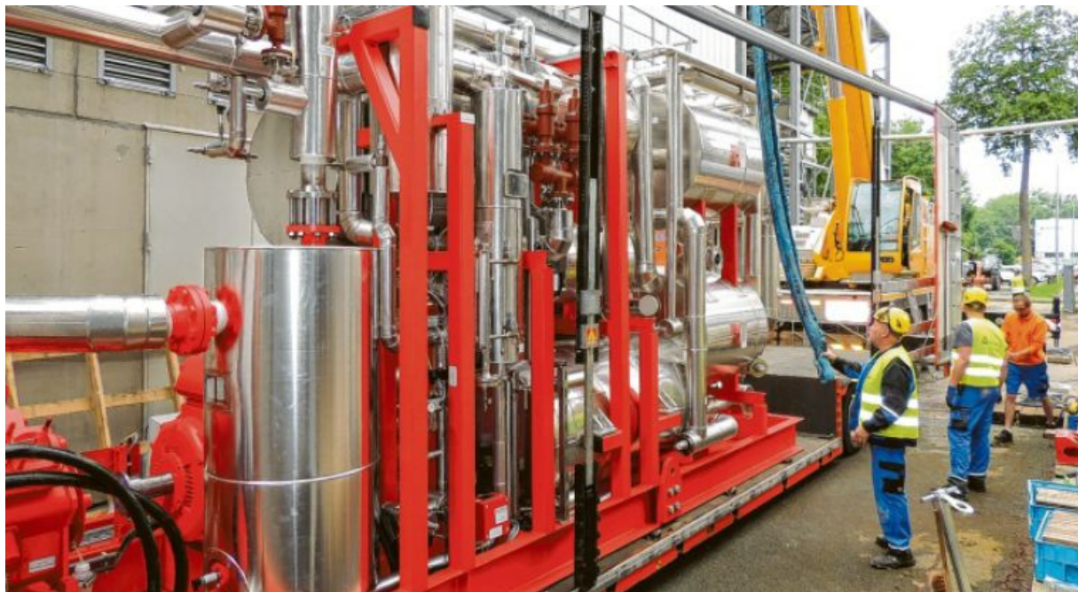
Als weltweit einmalig gilt diese monströse Wärmepumpe, die am Mittwoch ins Kraftwerk bei Verallia gehievt worden ist. Die Stadtwerke versprechen sich von der Neuheit eine kontinuierliche ganzjährige Heizzlieferung. Foto: Winfried Rein
